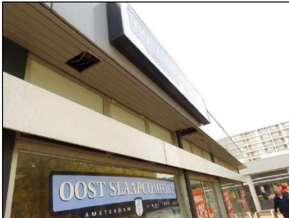
Figuur 10. Opengezaagde dakoverstek.
