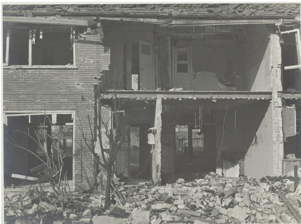
Foto 3. Schade aan de achterkant van Charlotte van Montpensierlaan 47-49.
